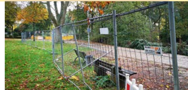
Ein Bauzaun verhindert den Zugang zum Entenweiher.
